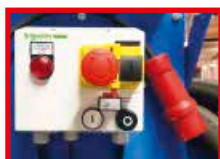
Quadro elettrico trifase
