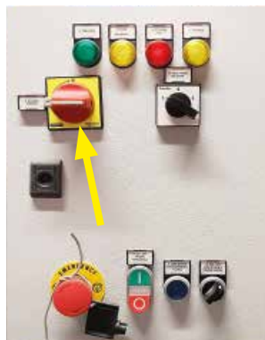
Con indicatore elettrico e contatore di particelle
