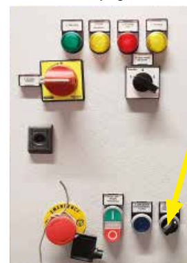
Con indicatore elettrico e contatore di particelle
