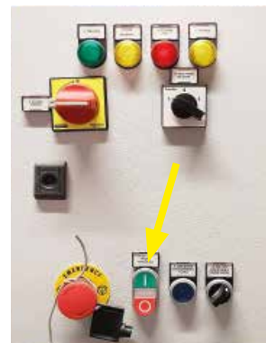
Con indicatore elettrico e contatore di particelle
