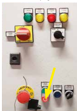
Con indicatore elettrico e contatore di particelle
