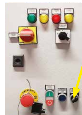
Con indicatore elettrico e contatore di particelle
