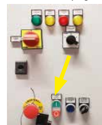
Con indicatore elettrico e contatore di particelle
