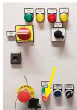
Con indicatore elettrico e contatore di particelle
