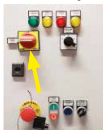
Con indicatore elettrico e contatore di particelle
