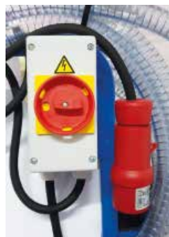
Quadro elettrico trifase
