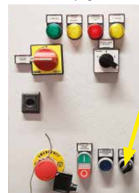
Con indicatore elettrico e contatore di particelle
