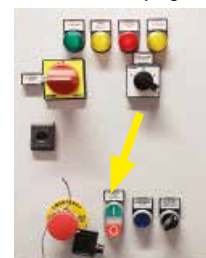
Con indicatore elettrico e contatore di particelle
