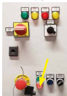
Con indicatore elettrico e contatore di particelle
