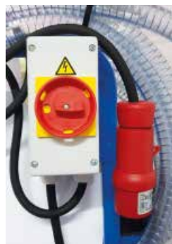
Quadro elettrico trifase
